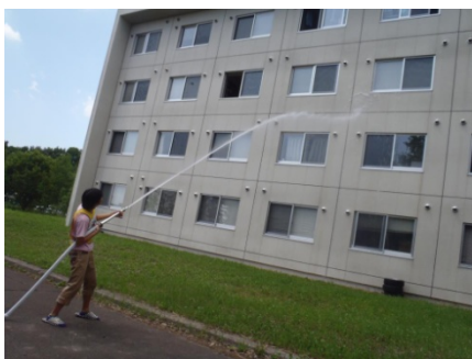
勢いよく放水される屋内消火栓
